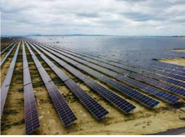
Proje İsmi : Karapınar Güneş Enerji Santrali Şehir : Konya Yatırımcı : Kalyon Enerji Tarih : 2023
